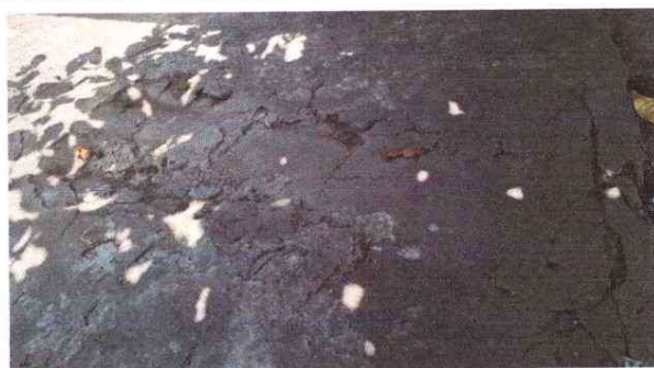
Foto 14: Sustrucción de torta de concreto
